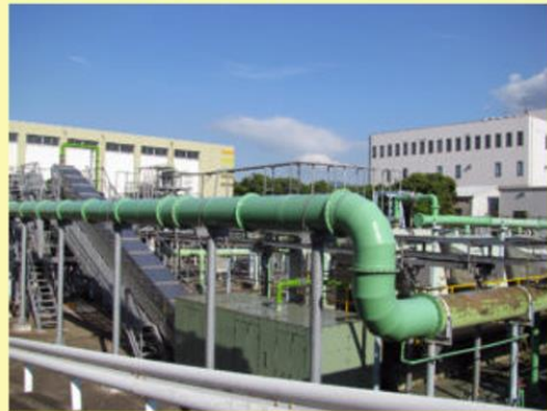
โรงบำบัดน้ำเสียฮากาชิ
